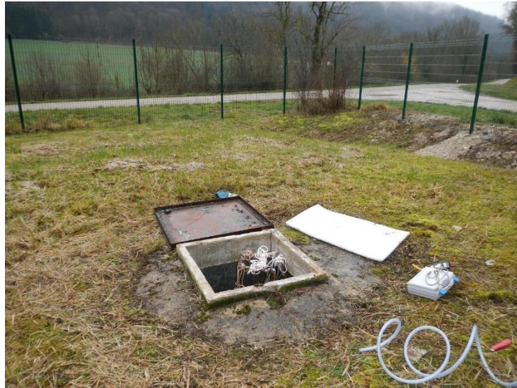
Figure 2 : Positionnement du fluorimètre et du préleveur automatique dans la source Claire Fontaine
